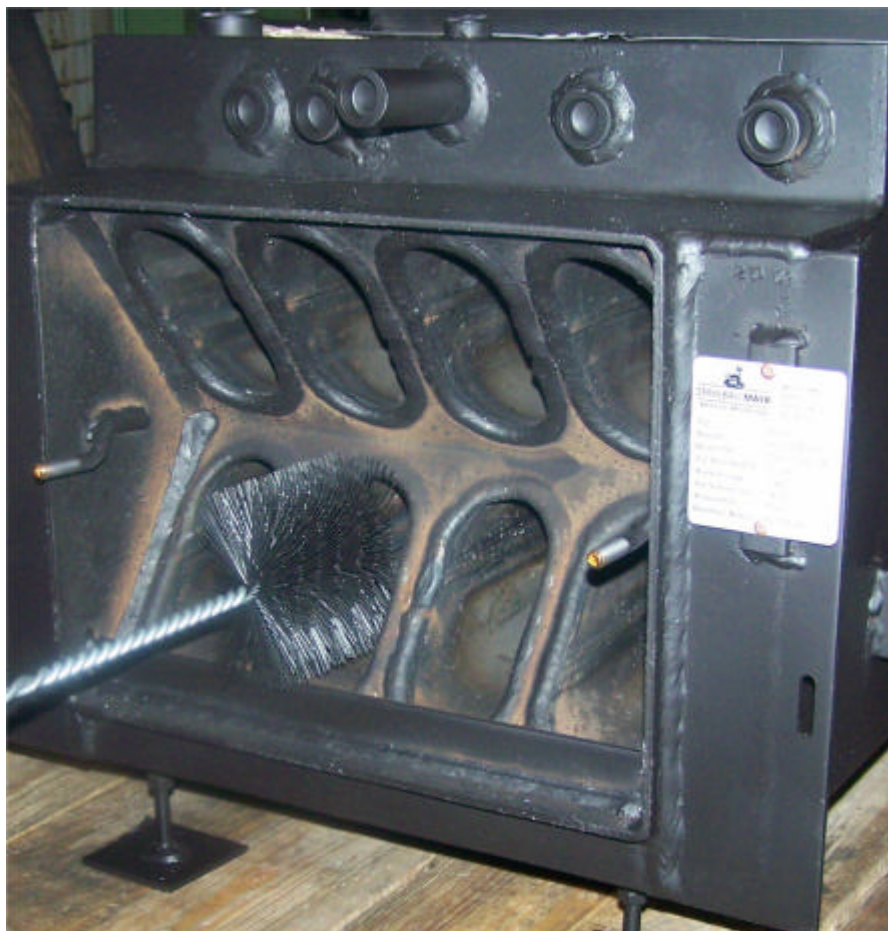
Ansicht der Rauchgasrohre bei geöffnetem Reinigungsdeckel
